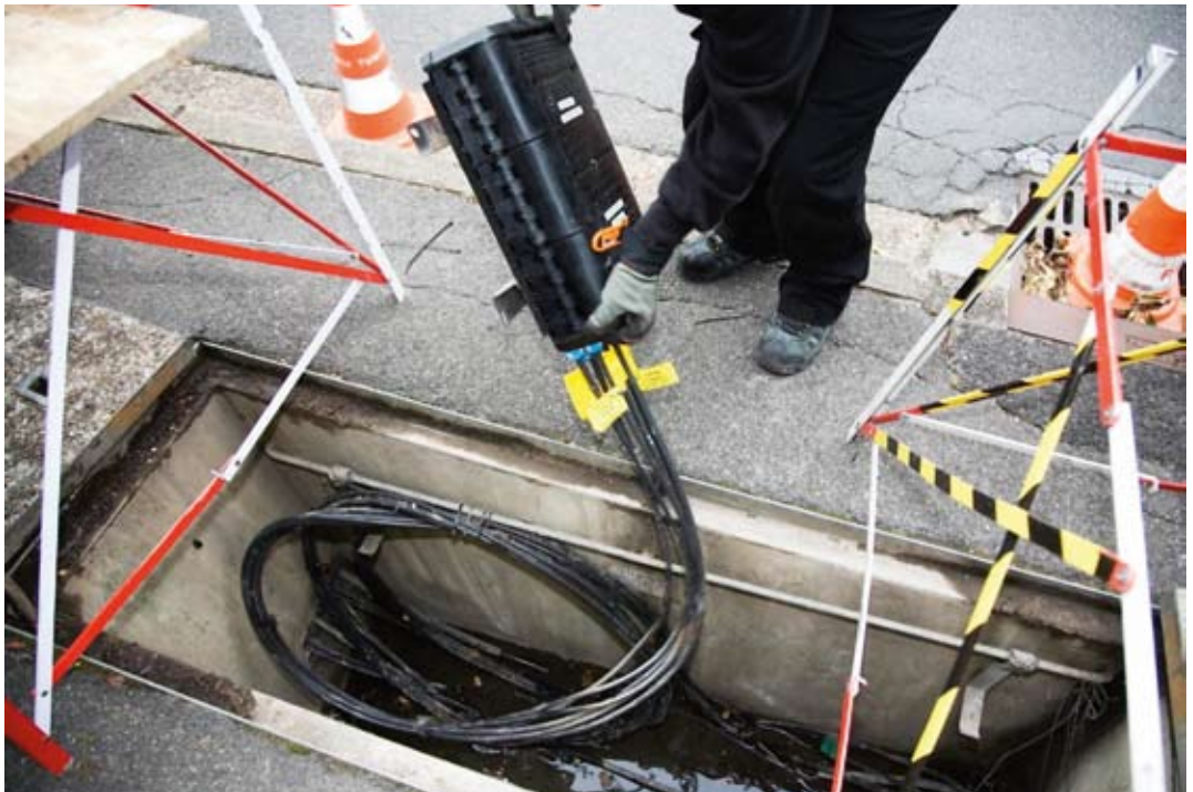
Fig. 4.1.11 Fibre connections in a street cabinet © François Maréchal for France Télécom Orange
