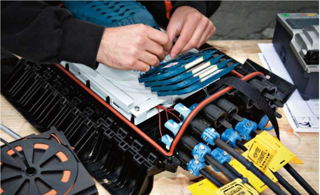
Fig. 4.1.12 Fibre connections in a street cabinet © François Maréchal for France Télécom Orange
