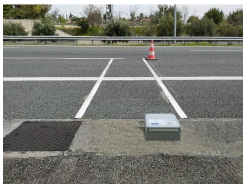
Ενθυλακωμένες διατάξεις αισθητήρων επί του οδοστρώματος κατά τις δοκιμές του συστήματος στην Αττική Οδό
